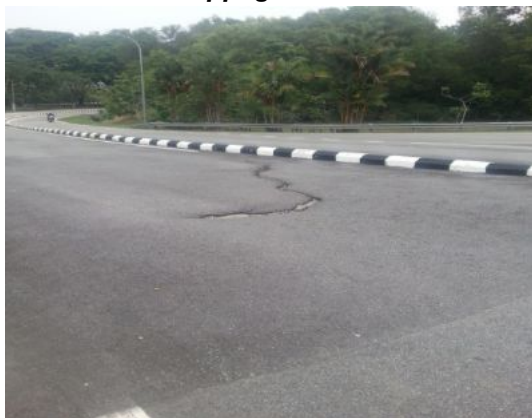
Gambar 1.3 Jalan Mengalami Kerosakan Jenis Slippage/Crescent
