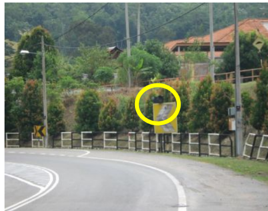
Gambar 1.9 Lampu Amaran Tidak Berfungsi
