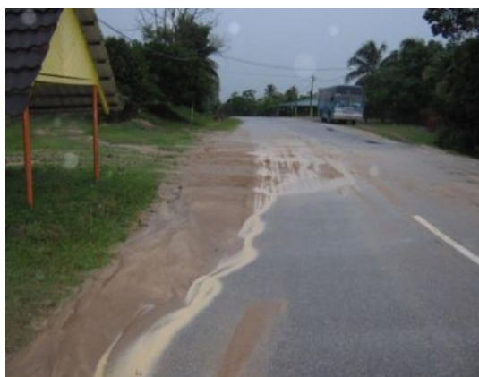
Gambar 1.26 Keadaan Jalan Yang Dipenuhi Pasir Di Lokasi Asal
