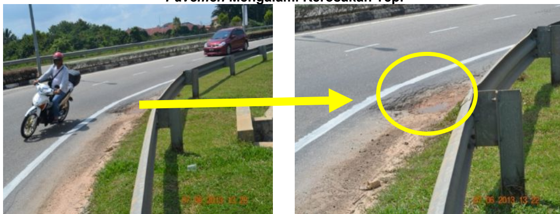
Gambar 1.21 Pavemen Mengalami Kerosakan Tepi
