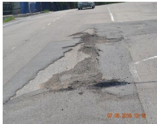
Gambar 1.4 Permukaan Jalan Rosak
