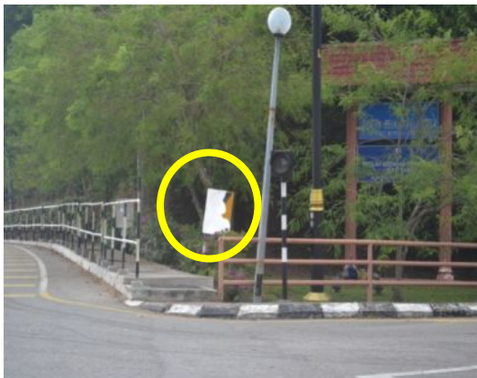
Gambar 1.8 Chevron Delineator Yang Telah Rosak
